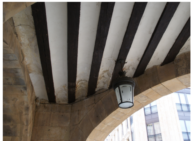
Zonas con goteras procedentes de la inadecuada impermeabilización de terraza superior
