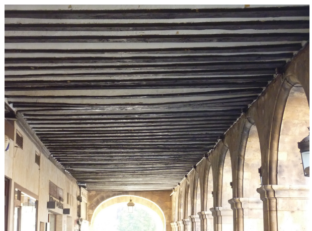
Fuerte deformación de los elementos estructurales (vigas)
