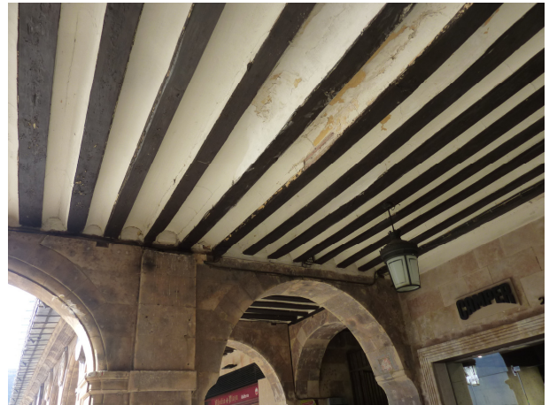
Zonas con desprendimiento de los revestimientos del entrevigado
