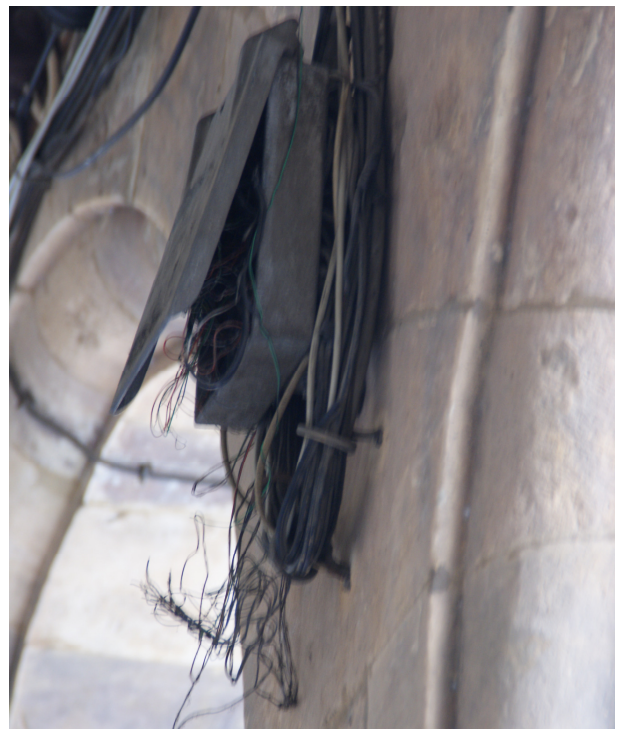
Cajas de instalaciones abiertas y con el cableado al aire
