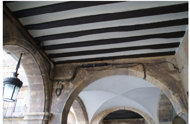
Cableados discurrendo por los paramentos de manera anárquica
