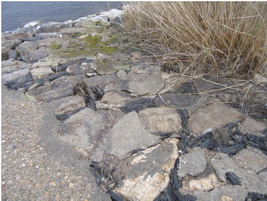
-El acabado que forra la fábrica exterior de la pesquera está realizado mediante lajas de piedras que a modo de mampuestos se extienden por la superficie, trabándose con ripias de pizarra acuñaadas. En época reciente, ya del siglo XX fue cubierto y sellado por una fina capa de hormigón.
