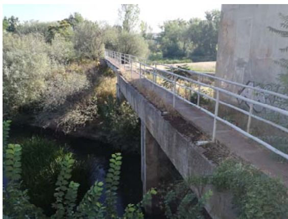
6 Imagen conducción de saneamiento-pasarela en la trasera de la Fábrica de la Luz. Fuente: Propia
