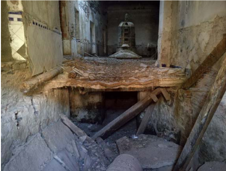
9 Vista del interior desde acceso con forjado arruinado y maquinaria al fondo. Fuente: Propia
