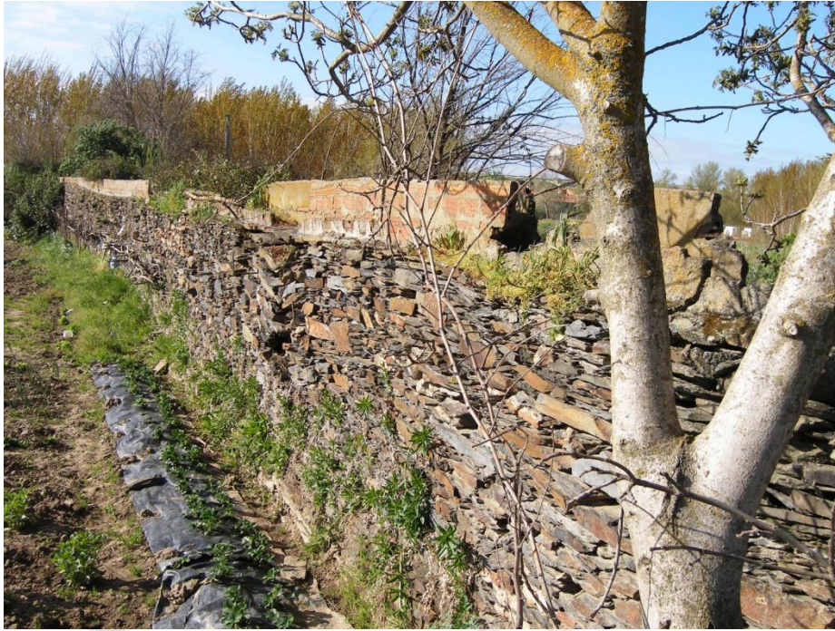
Muro tradicional de piedra conservado entre la noria y el río, al que se le añadió un canal de riego en su coronación.
