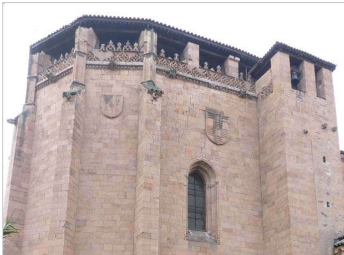
Fig. 7.- Fotografía del ábside de la iglesia donde se ve claramente cómo la cubierta se desarrolla por encima de la crestería y descansa sobre los pináculos cortados en altura.
