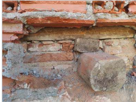
Fig. 87.- Fotografía del trozo que se picó en de la franja superior de ladrillos huecos y donde quedó a la luz parte de una estructura de madera seguramente correspondiente a la cubierta de esta panda.
