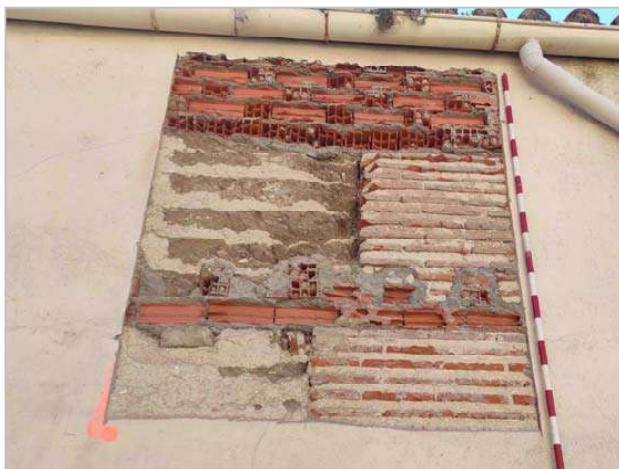
Fig. 85.- En esta fotografía se ven las tongadas de tierra con la que ha sido construida la tapia, los machones de ladrillo macizo y los ladrillos huecos que están tapando los mechinales donde apoyaría la estructura de un antiguo tejadillo.
