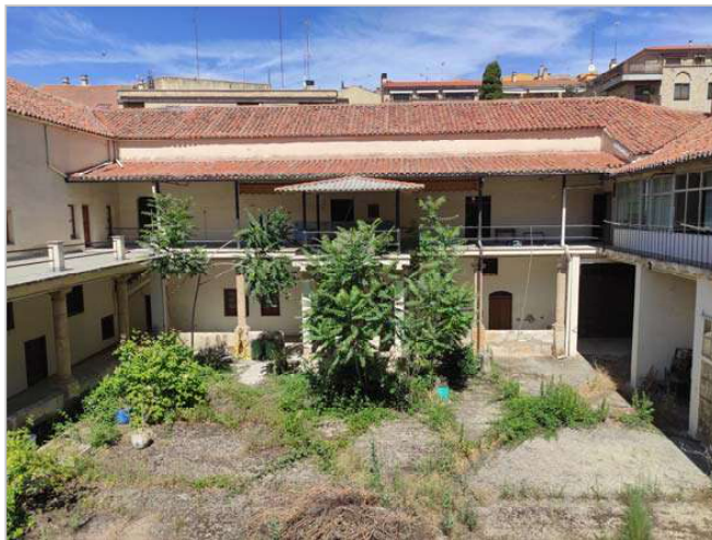
Fig. 77.- Fotografía actual del claustro, donde se observa cómo el lado S está completamente abierto, el W cubierto con un tejadillo y el N cerrado con una galería acristalada.
