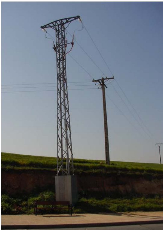
Imagen de la línea eléctrica que atraviesa la parcela
