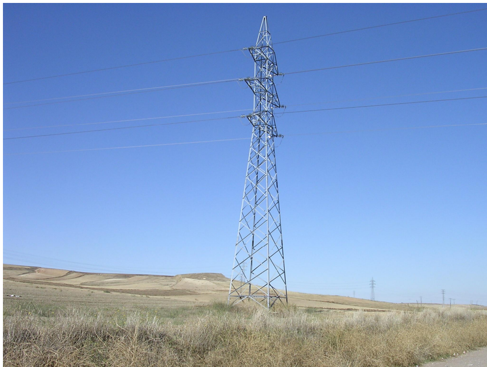
Foto 11 Torre de AT.
