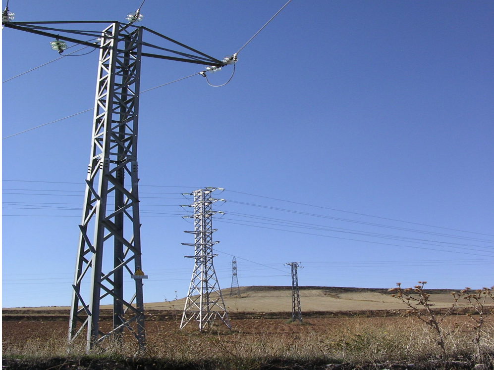
Foto 17 Líneas eléctricas de AT.
